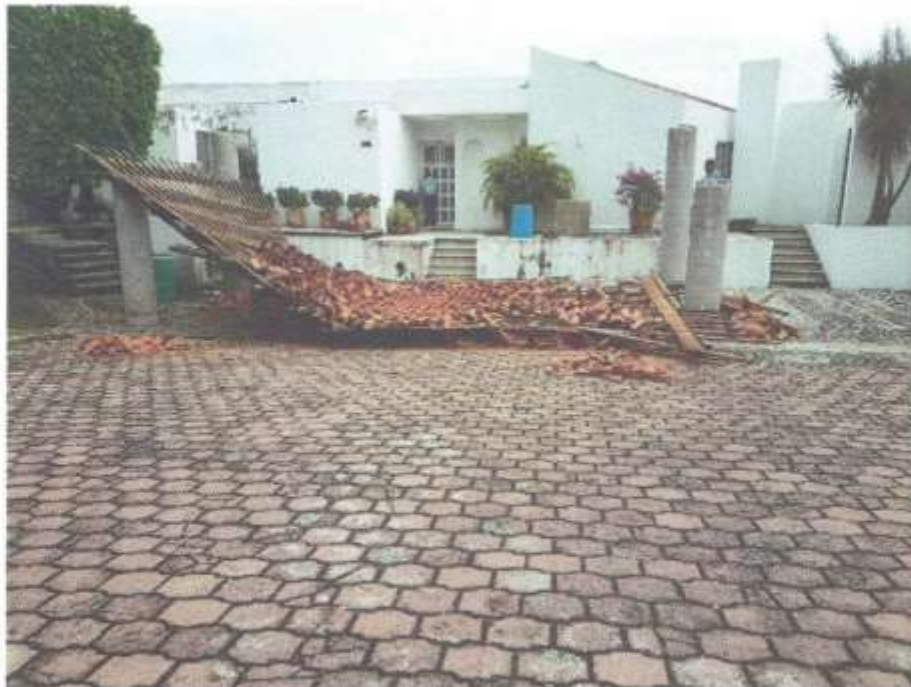
Figura 18 Colapso de techumbres en estacionamiento. Cerrada de Tules.
