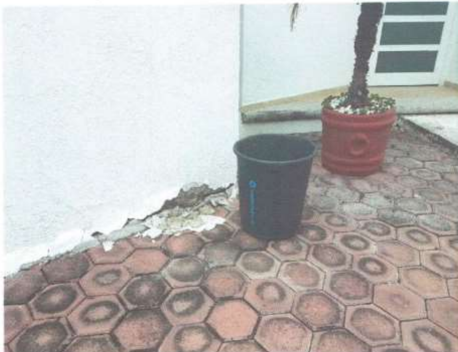
Figura 16 Desprendimientos en contactos Losa-Terreno. Cto Palmeras.
