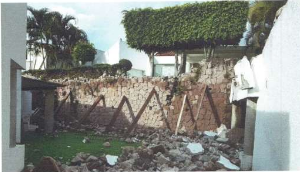
Figura 29 Muro de contención colapsado en Cto. Palmeras 26 (MC 08).
