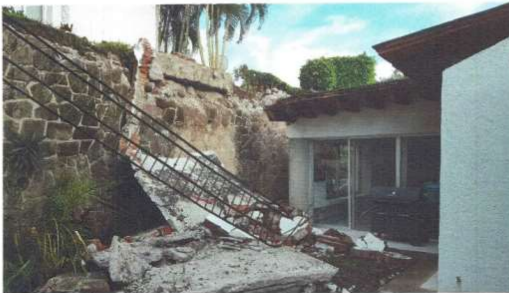
Figura 30 Muro de contención colapsado en Cto. Palmeras 28 (MC 08).
