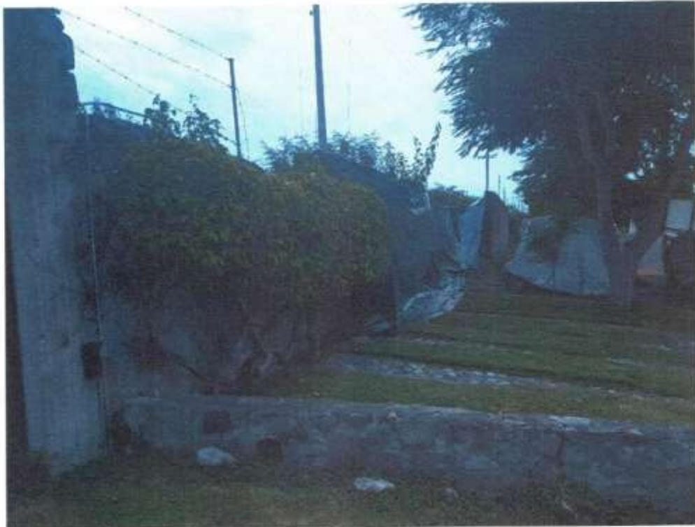
Figura 22 Muro de colindancia colapsado en zona de cerrada del Castillo. (MP 2).
