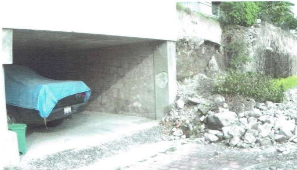
Figura 28 Muro de contención colapsado en Cto. Palmeras (MC 05).
