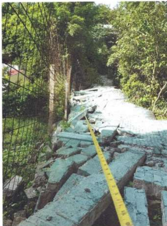
Figura 21 Muro de colindancia colapsado en zona de Privada de Fresnos (MP 4).
