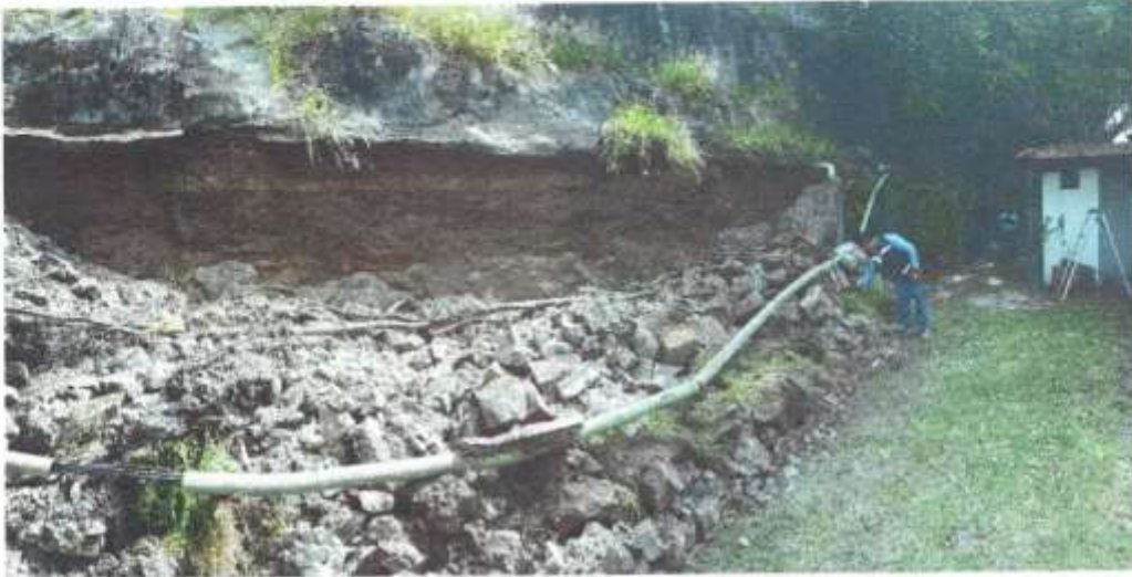
Figura 25 Muro de contención colapsado en el fondo de Priv de Fresnos (MC 01).
