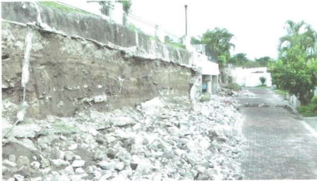
Figura 27 Muro de contención colapsado en Cto. Palmeras (MC 04).
