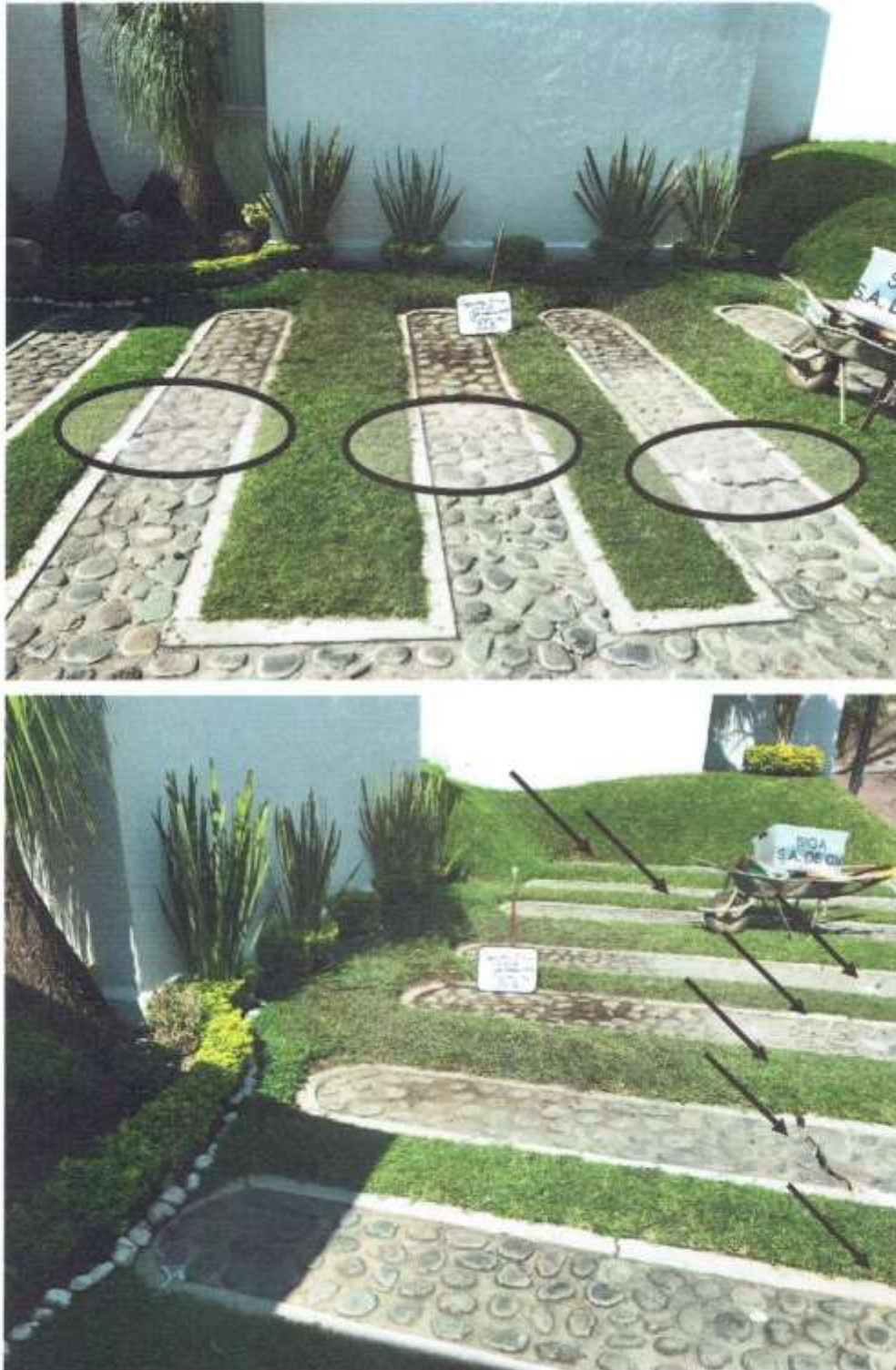
Figura 33 Fracturas en el terreno Palmeras No 42 en Manzana 13.
