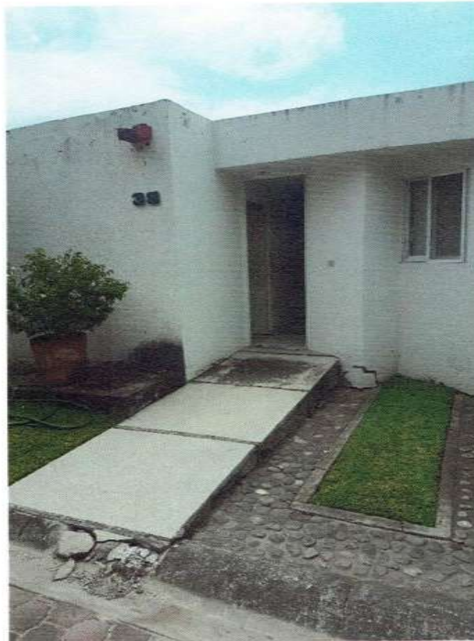
Figura 19 Afectación en desplante de casa y estructuras aledañas. Cto Palmeras, Manzana 13.
