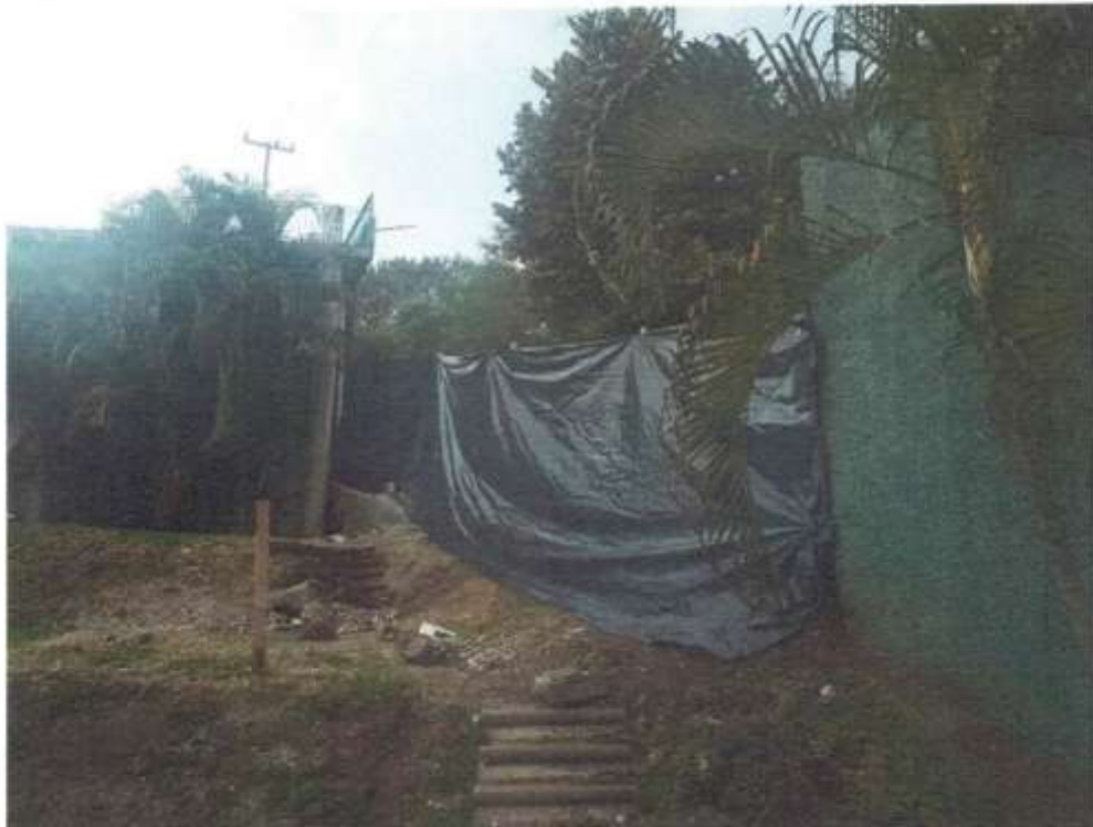
Figura 23 Muro de colindancia colapsado en zona de Cto Palmeras, área privada (MP 6).
